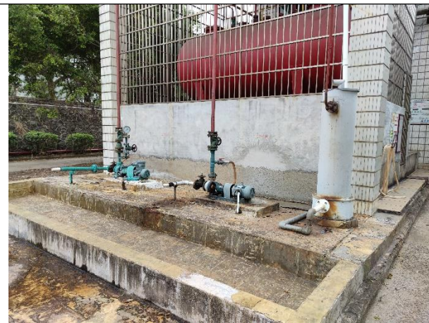
酸碱储罐围堰
